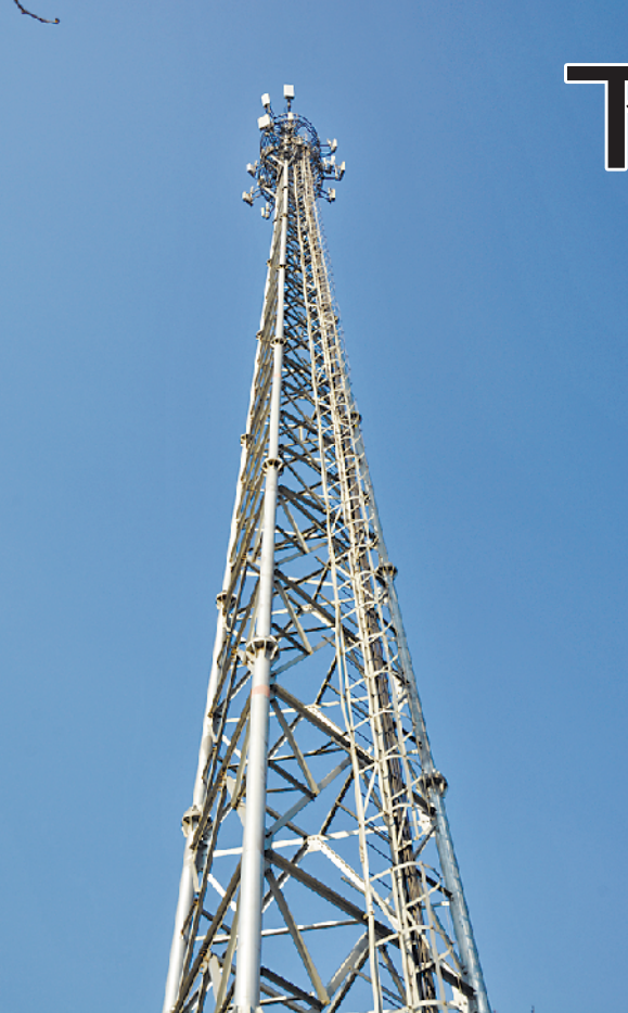
图为已投入使用的通信基站。
