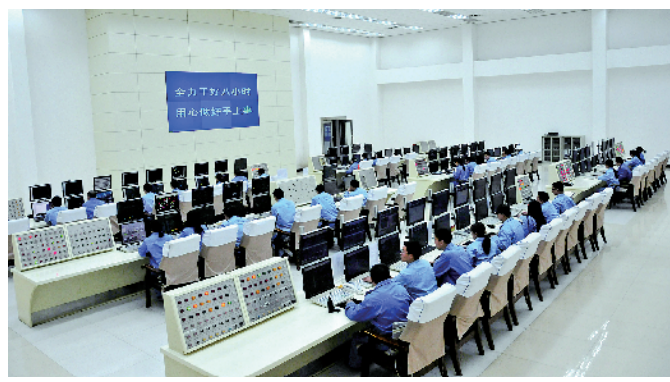
中原大化中心控制室。
