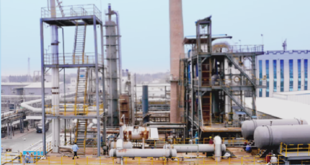
固废处理装置。
