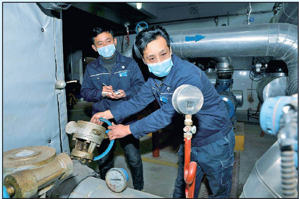
全力以赴 保供暖 冬季供暖事关民生。市热力公司供热八大队时刻关注天气变化和供热参数，全力做好供热保障。图为1月15日，在开发区一中供热站内，该供热大队维修人员正根据调度指示调节温度。 本报记者 高峯 通讯员 姚永美 摄
