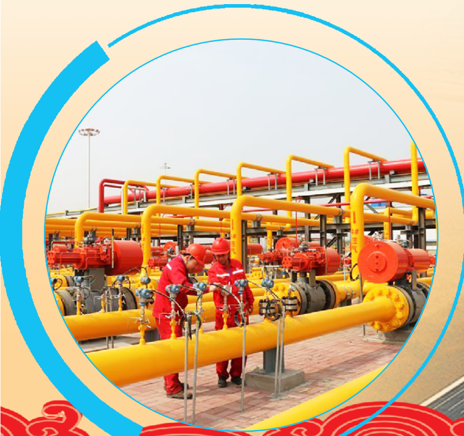
文 23 天然气储气库。
