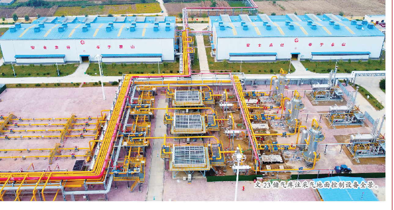
文 23 储气库注采气地面控制设备全景。
