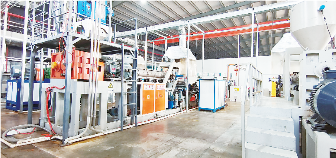
南乐华乐科技有限公司数字化原料生产车间。
