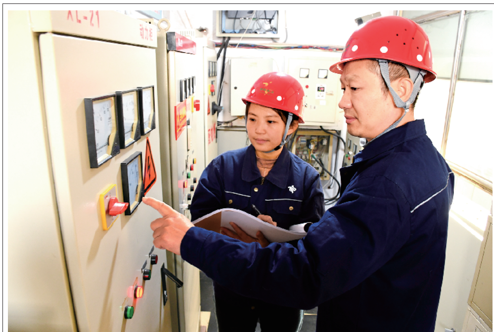
随着气温逐渐降低,今冬供暖工作也进入倒计时。记者了解到,目前我市供暖物资储备充足,各项前期准备工作已基本就绪。图为10月22日,市热力公司北区分公司员工正在调试运行设备。⑩
