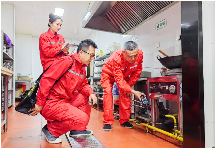
4月24日，中原油田房地产管理中心工作人员对辖区商户开展燃气安全专项检查。针对发现的线路老化、胶管松动等问题，现场下达整改通知并跟踪督办，切实筑牢商户安全生产防线。⑩
