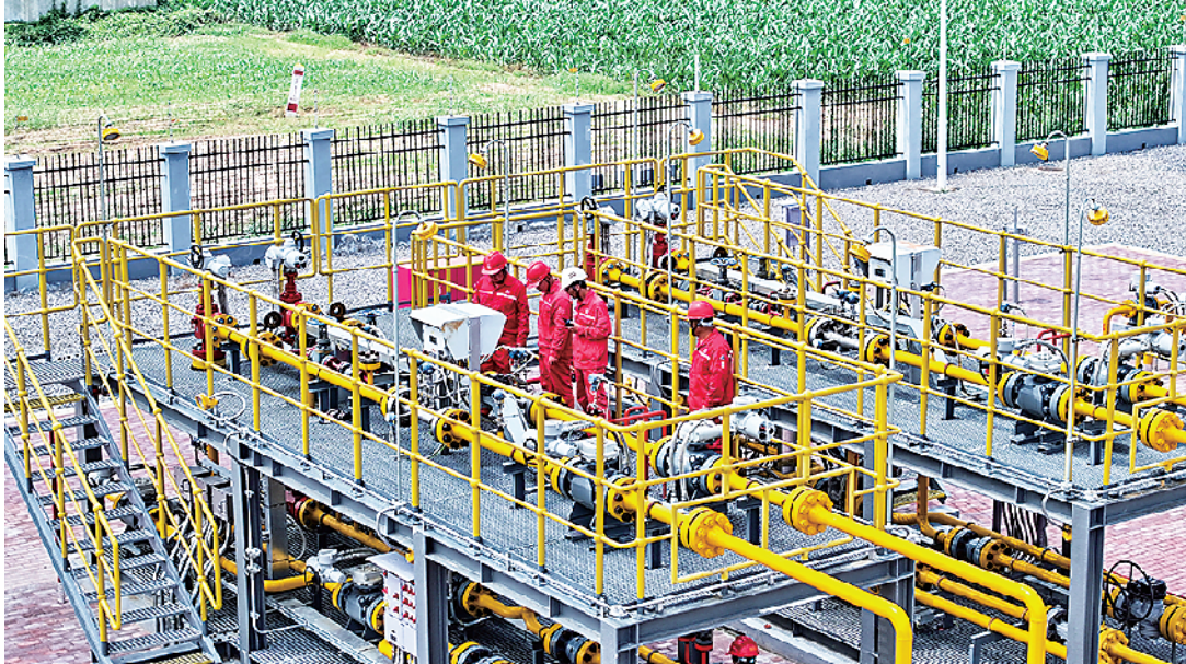
中原油田员工对白庙浅层储气库的撬装装置等设备进行巡检。
