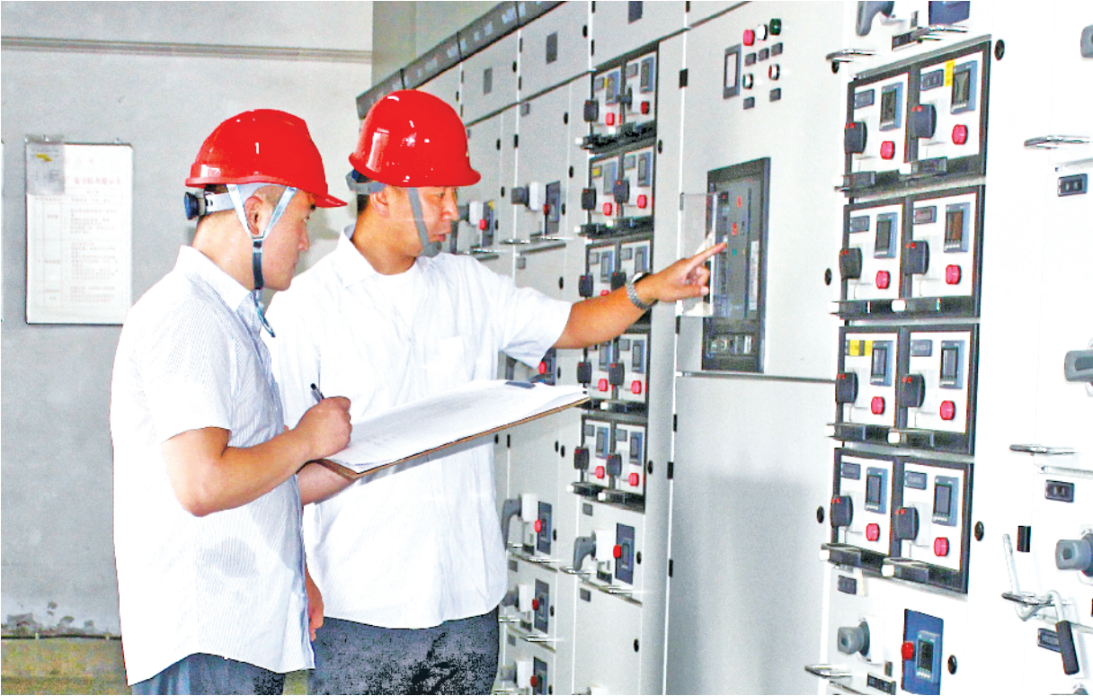
连日来,持续高温天气给安全生产带来多重挑战。为切实防范风险,市自来水有限公司迅速部署,从风险排查、防暑保障、供水稳定等多方面发力,全力筑牢夏季高温期间安全生产防线。图为7月11日,该公司生产运行车间工作人员对高低压间控制室的电气设备进行巡检。⑩ 本报记者 高釜人 通讯员 冯冰 摄
